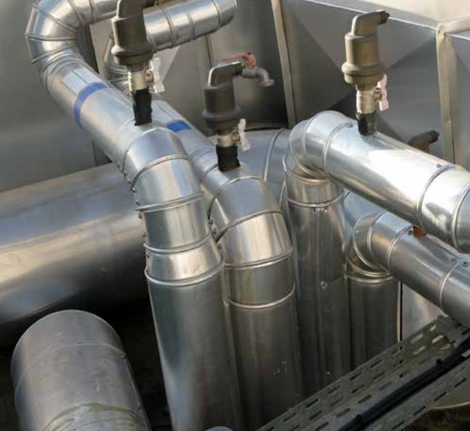
Un système de ventilation.
